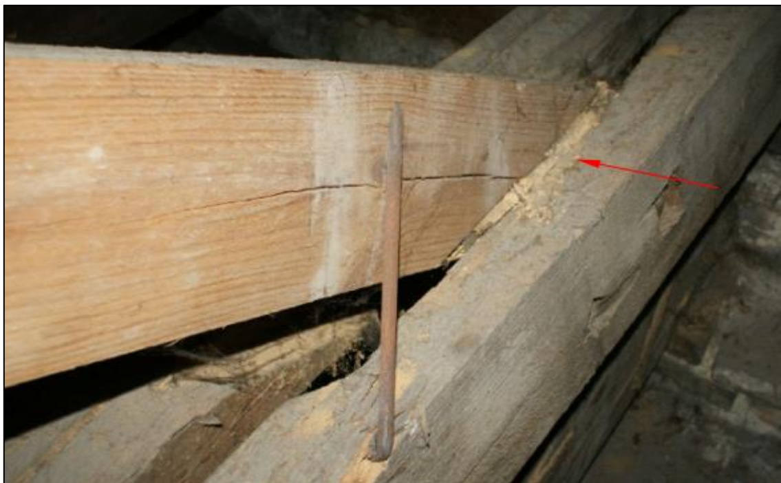
19. ábra: A kipótolt ferde dúc alatt látható a bent maradt károsított darab (a szerző felvétele)
