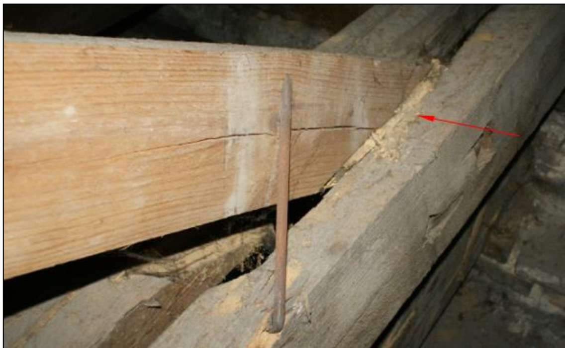
29. ábra: A kipótolt ferde dúc alatt látható a bent maradt károsított darab (a szerző felvétele)
