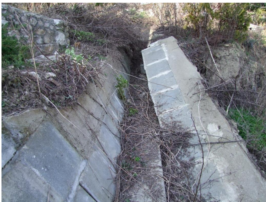
2. kép: A 2010-2011-es csuszamlások által megrongált csapadékelvezető árok. (készítette: Kalmár Péter)
