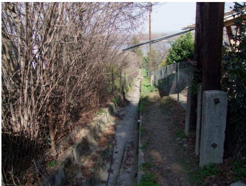
1. kép: A csapadékelvezető árok Kulcs üdülöterületén. (készítette: Kalmár Péter)
