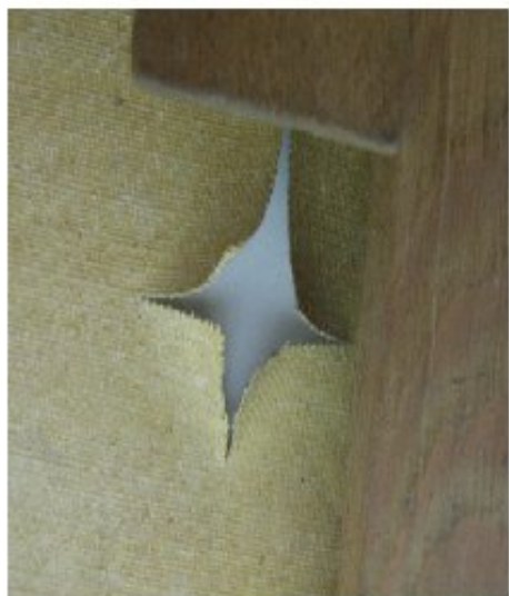
14. ábra –szakadás a hordozón
