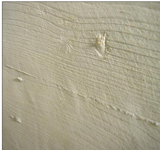
24. ábra: Betonlerakódás a 3. próbatest P3-mas felületén
