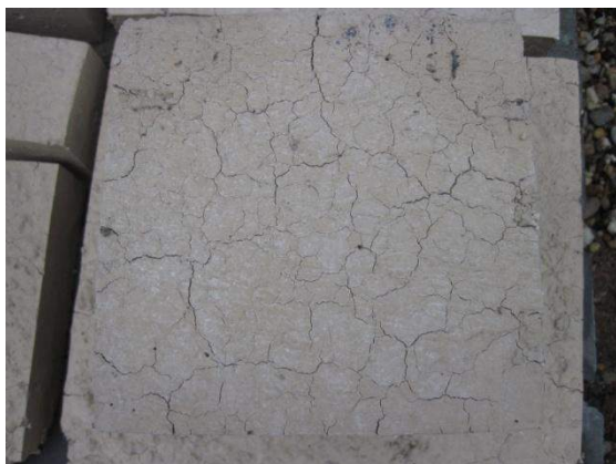
38. ábra – Pókhálós repedéshálózat
