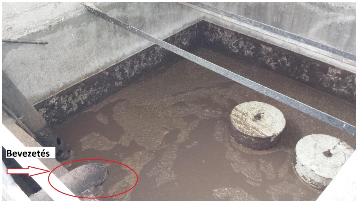
9. kép: Iszapsűrítő régi bevezetése
