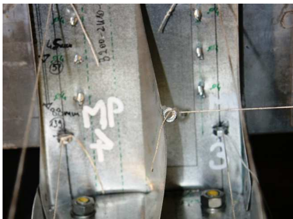
7.21 kép Gerinclemez deformálódása
