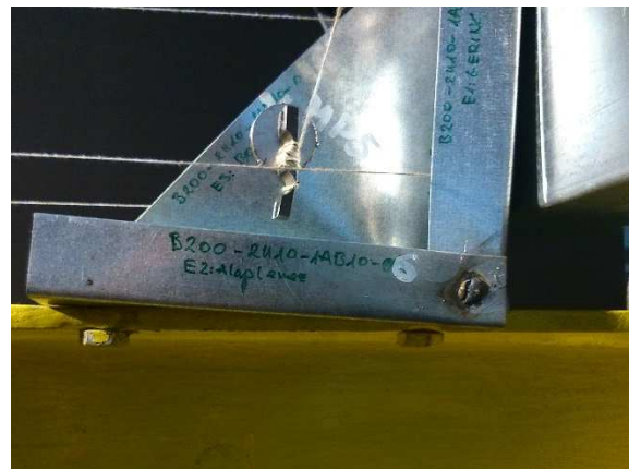
7.9 kép Deformálódott alaplemez
