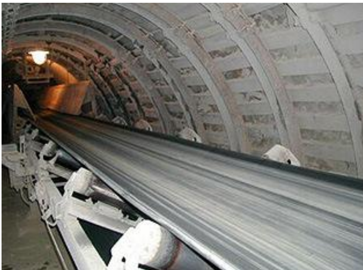
2. ábra: Föld alatti szállítószalag
