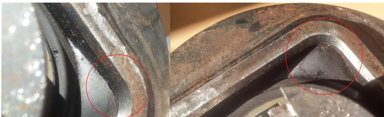
22. ábra elvált gumi-fém kapcsolat
