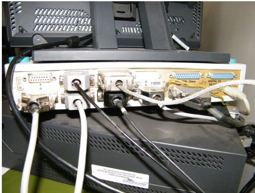
9. ábra SPIDER 8 csatlakozásai (forrás: SZIE GÉK GÉTI)
