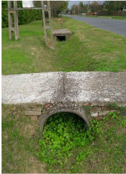
3.1. ábra. Egy felújítást igénylő árok
