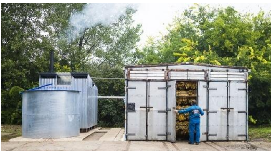
6. kép: Apríték tüzelésű automata kazán a TDO-80-as szárítóberendezéshez kapcsolva (Forrás: MADOSZ, 2014b)
