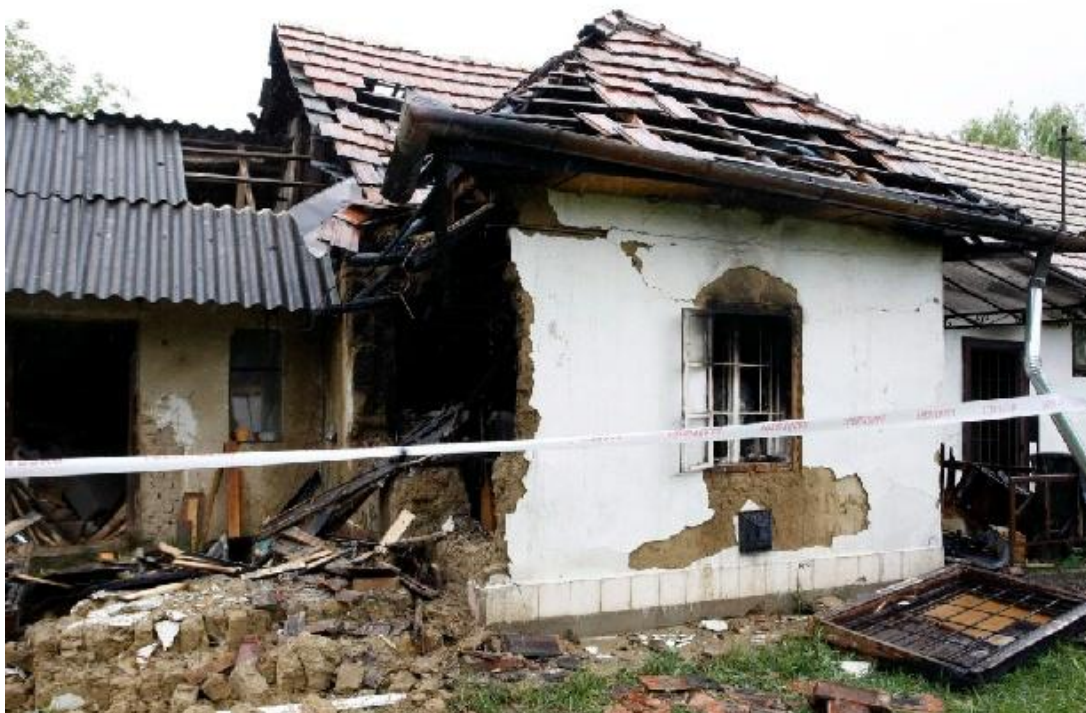
34. ábra: Vályog épület gázrobbanás után Forrás: http://www.hirado.hu/2014/04/25/gazrobbanas-miatt-kigyulladt-egy-haz-kokan/ , Letöltés ideje: 2014.10.28 14:55
