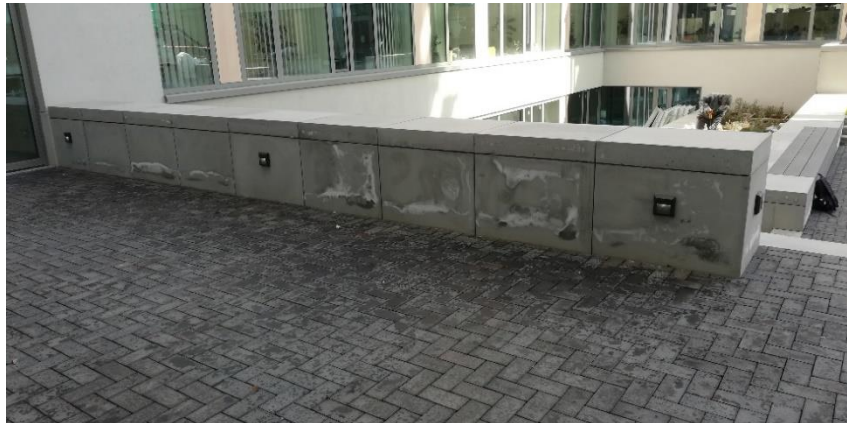
28. ábra: Kivirágzott beton felület
