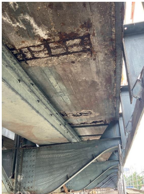
4.3. ábra: Korrózió a járdalemezen.
