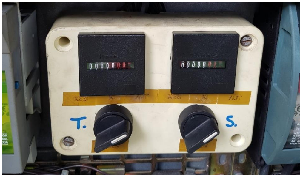
22. ábra: Újonnan beszerelt üzemóra számláló mindkét szivattyúhoz
