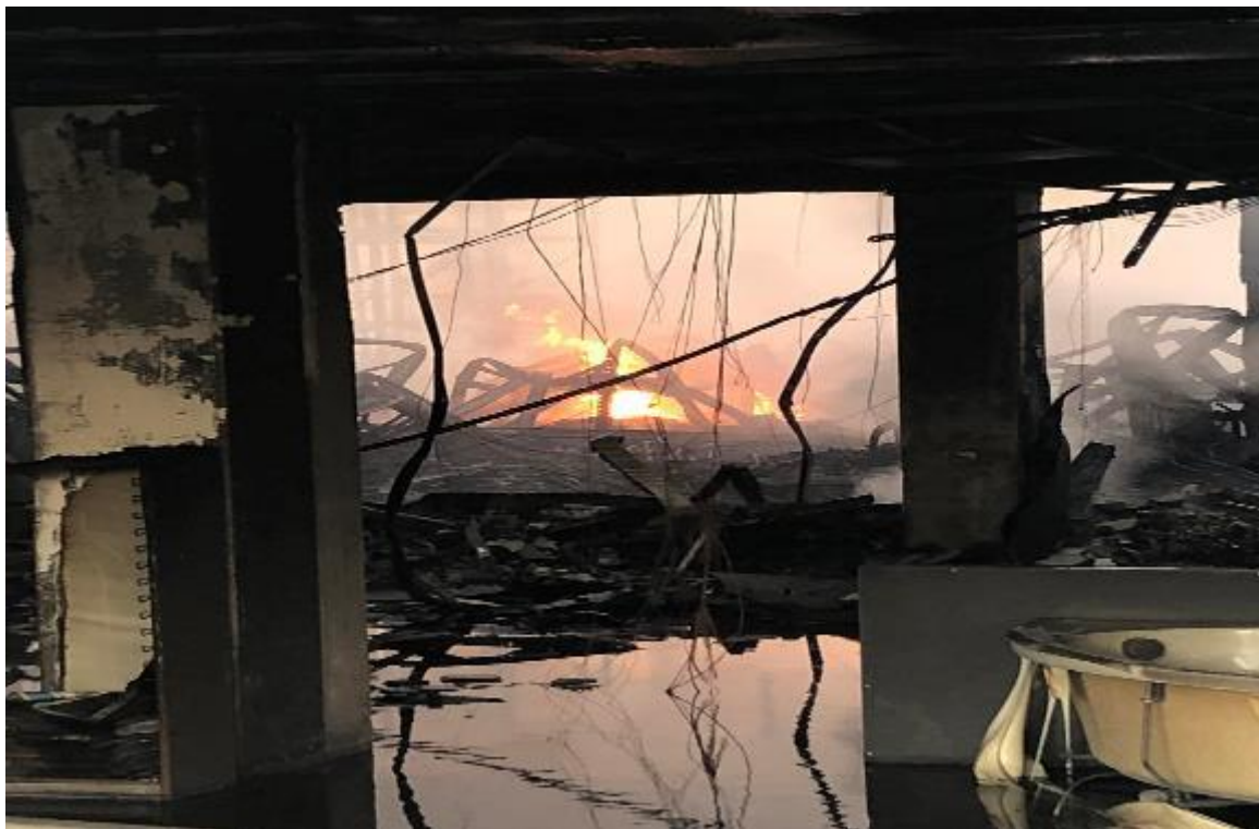
16. ábra Vasbetonszerkezet és fémszerkezet beomlás után (X kerületi káreset 2021.10.)
