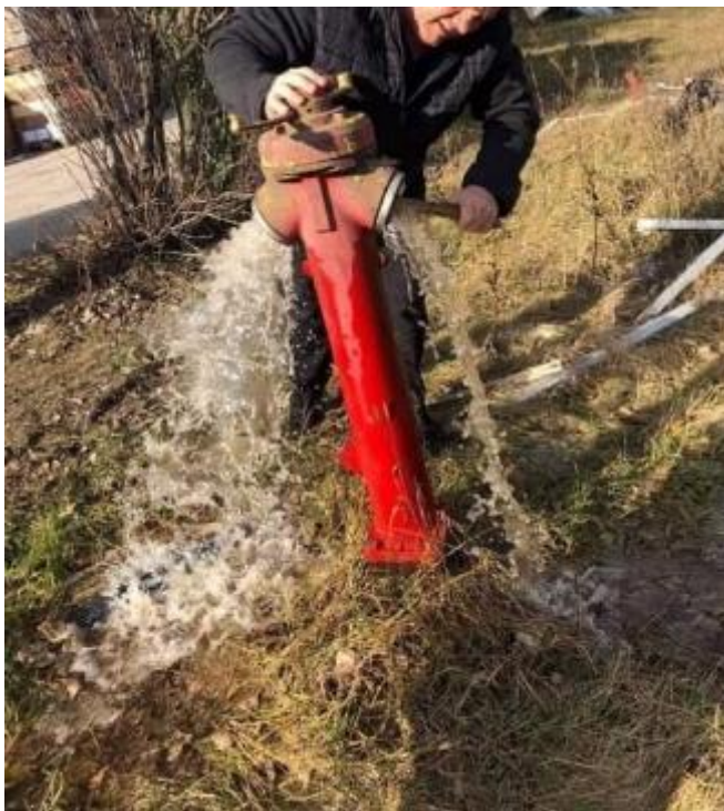
25. ábra Földfeletti tűzcsap nyomásprobléma rendszerhiba miatt
