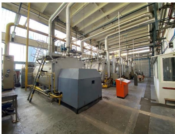
18. ábra: A Hódítói Fűtőműben lévő Láng gyártmányú forróvizes kazánok balról, jobb oldalon az iroda, a kettő között a vezérlőegységek láthatóak
