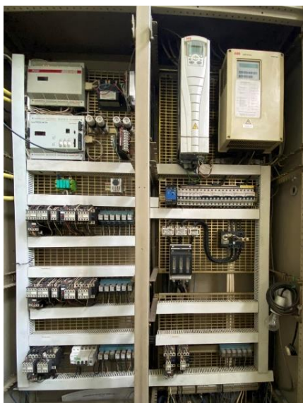
22. ábra: PLC vezérlőszekrény
