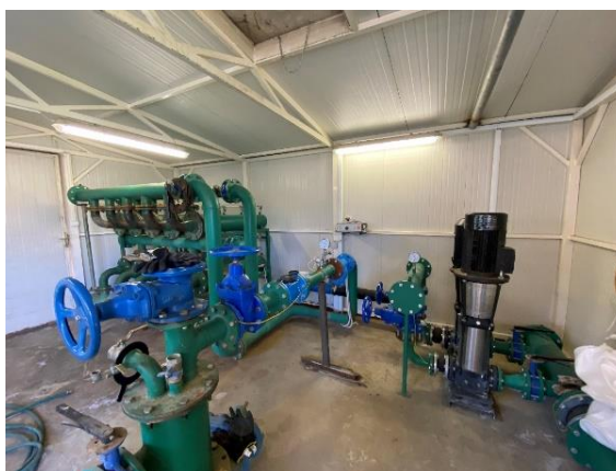
25. ábra: Jobbról: szivattyú, balról: szűrőberendezés, elől: II. számú visszasajtoló kút, valamint a két nyomás mérő, a szűrő előtt és után
