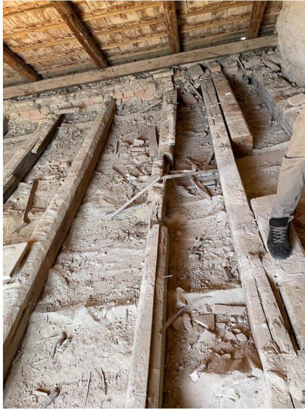
15. ábra Szakszerűtlen bevágások, kigyengítések
