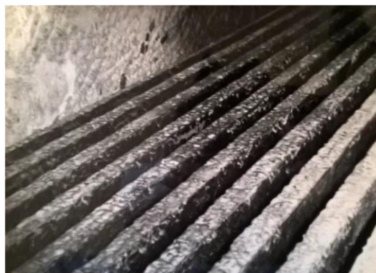
6. ábra: Korrodált lánclemezek [2].
