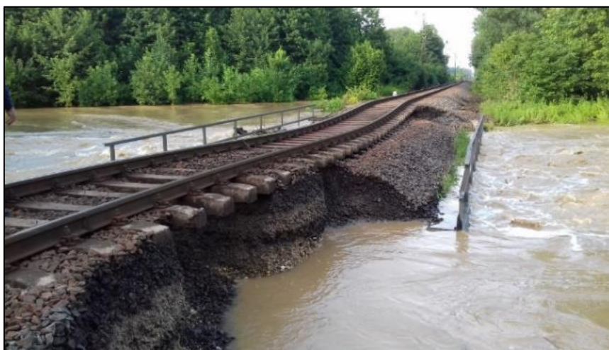
1. kép A rinyai 2020-as árvíz által alámosott vasúti híd (forrás: MÁV csoport honlapja)
