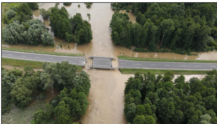
2. kép A rinyai 2020-as árvíz során károsodott közúti híd (forrás: AtúdHír)
