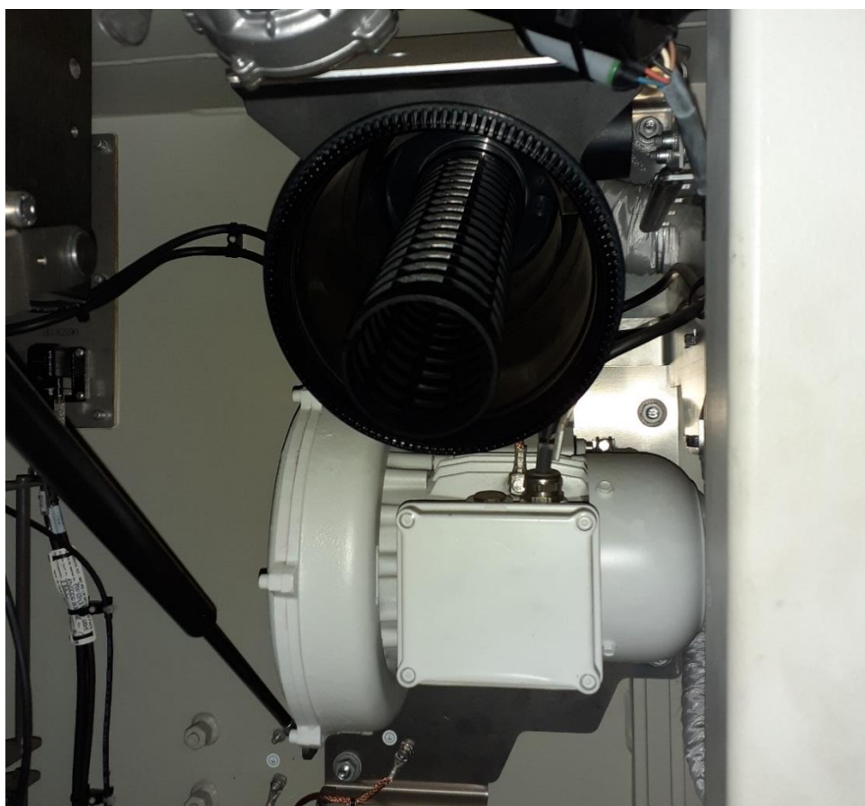
3. melléklet 11. ábra: Az egyik túlnyomást biztosító ventilátor beépítési helye
