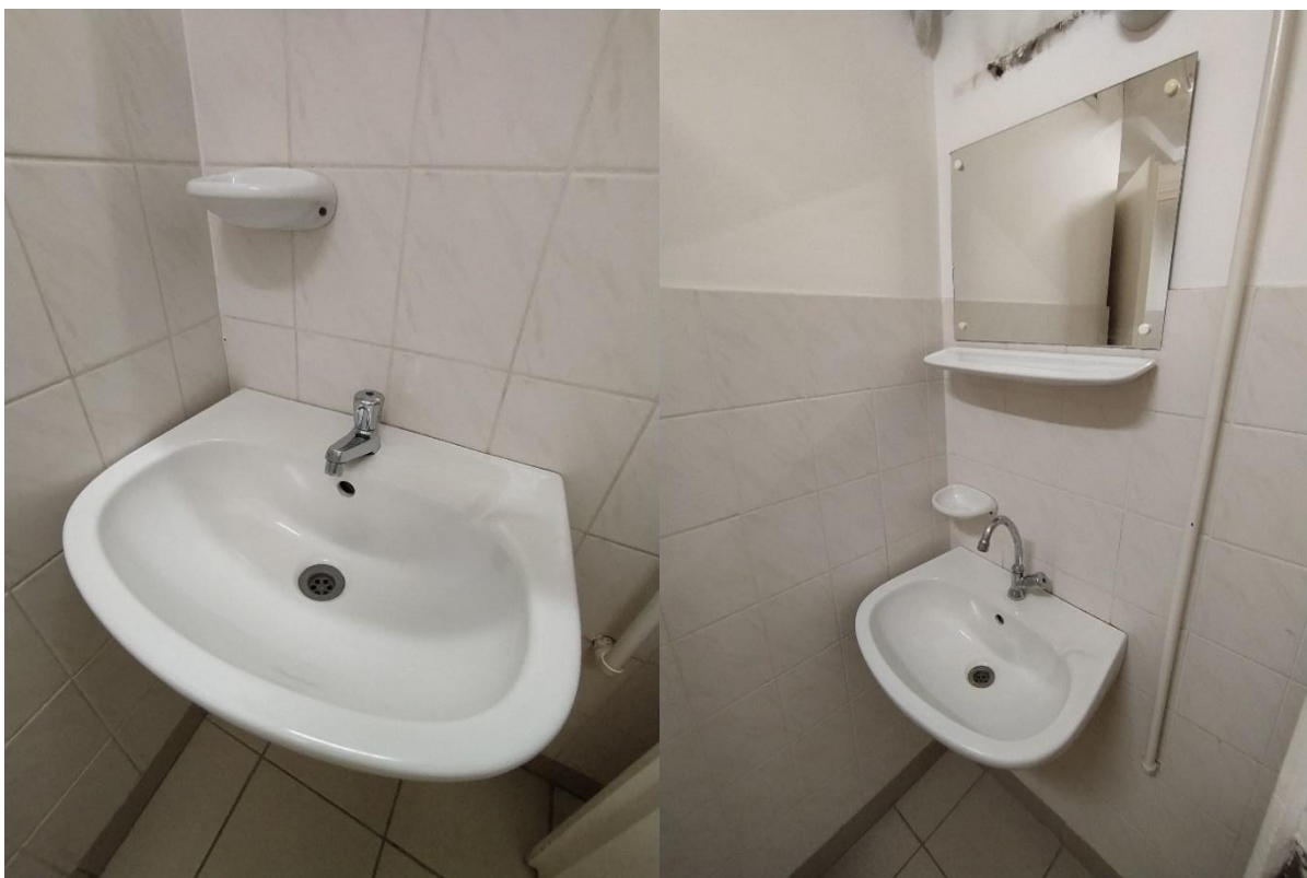
[7.3 ábra – WC-ben elhelyezett kézmosó berendezések]
