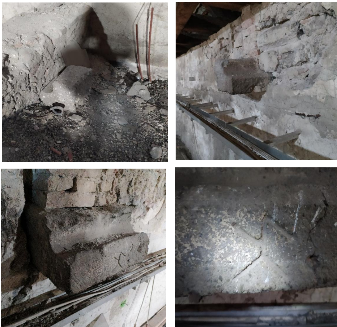
A padlás falában talált kőborda darabok, az alsó két képen látható a kőműves szimbólum is rajtuk (forrás: saját)
