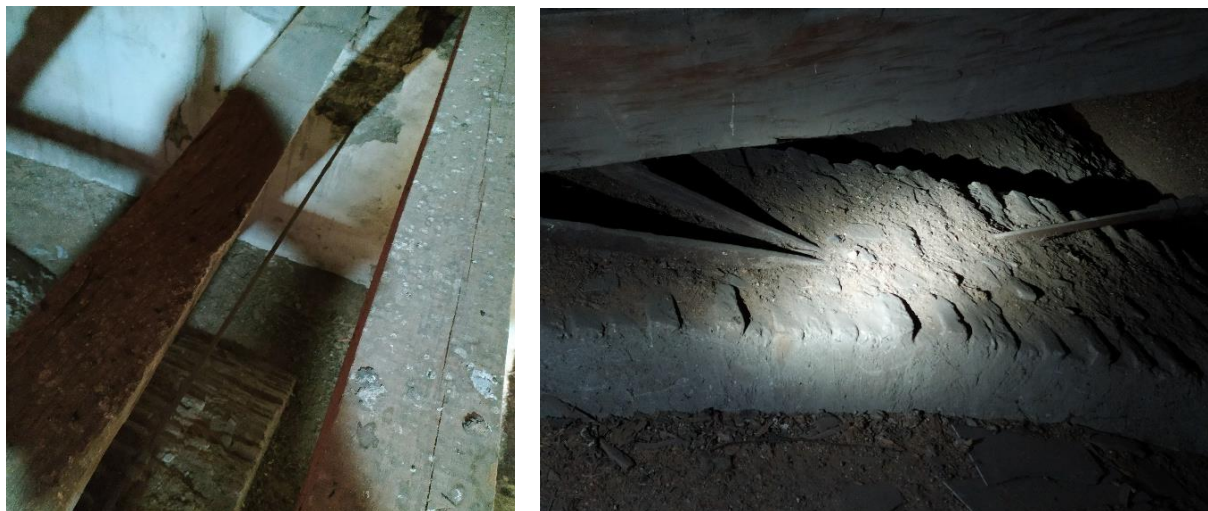
Képek a vonóvas, a boltív és a fal kapcsolatáról (forrás: saját)
