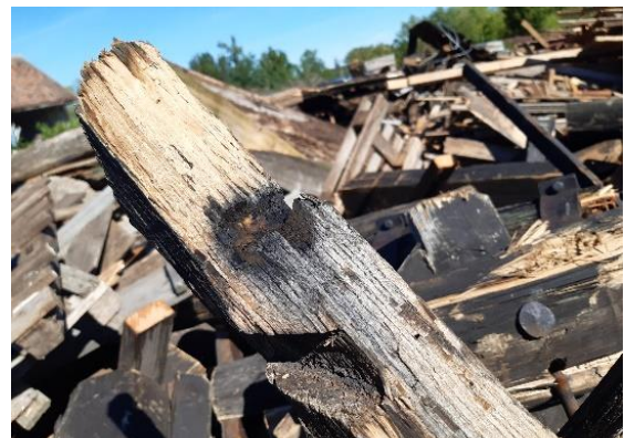
17. ábra: Oxidálódott csavarhely [1]
