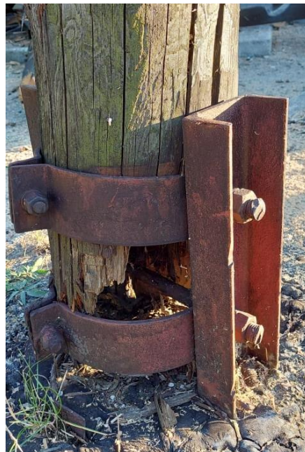
8. ábra: A kilátó korhadt lábazata [1]
