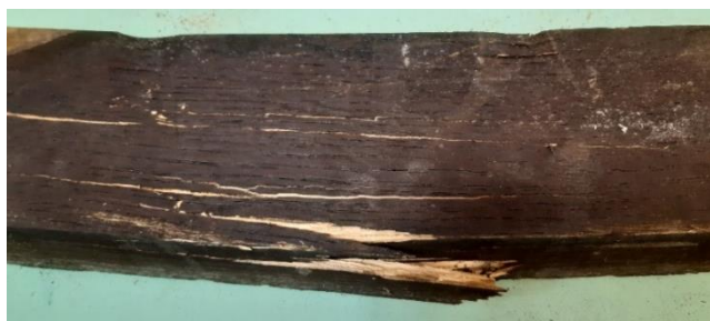
50. ábra: Szálkás, hajlításból származó repedés [1]
