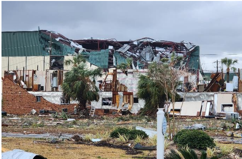
3. ábra: amerikai tornádó okozta épület összeomlás [6]
