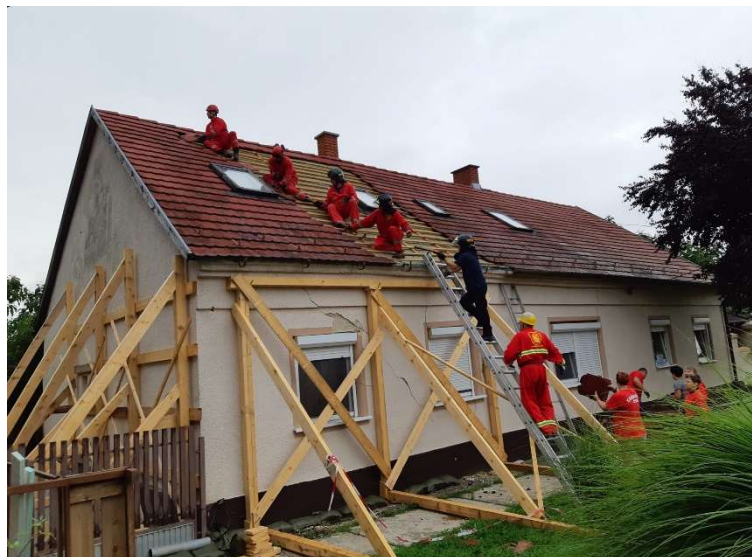
2. ábra Belvíz rongálta családi ház támasztása
