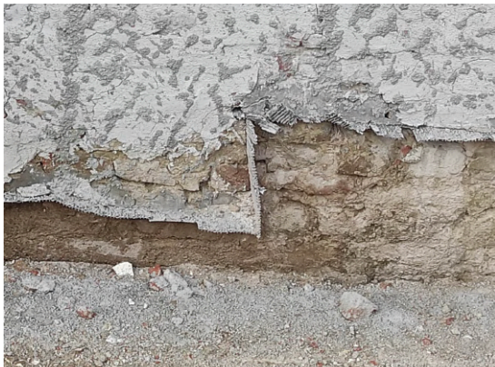
80. ábra: HIO-lemez hibás függőleges vízzárja
