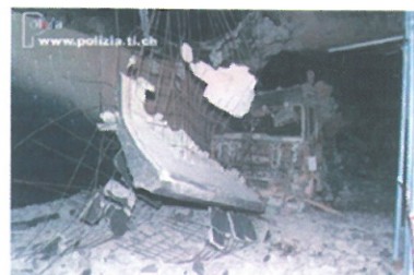
2. ábra: Gotthárd-alagút betonfelületének réteges leválása [5]
