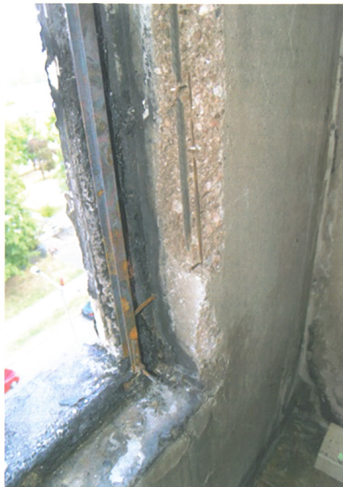
6. ábra: Betonfedés sajátos leválása az ablak mentén, sarokban, a Miskolc, közepszer u. 20 sz. alatti paneles lakóépület 2009. augusztus 15-i tüzeseténél [14]
