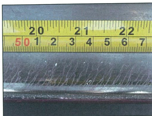
1. ábra. Hajszálrepedések a futófelületen [1]
