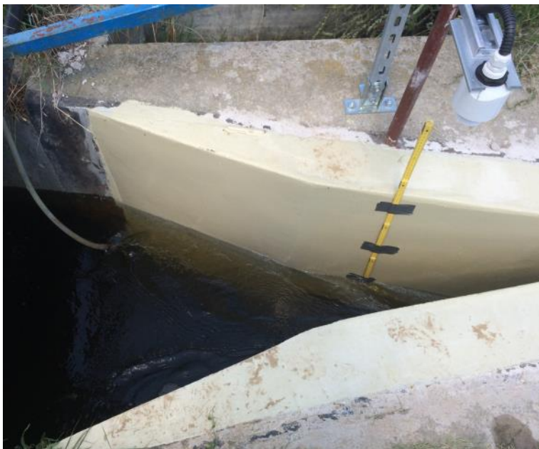
A Parshall csatornán kialakított vízmélység rögzítési szelvényt mérőrúddal jelöltük
