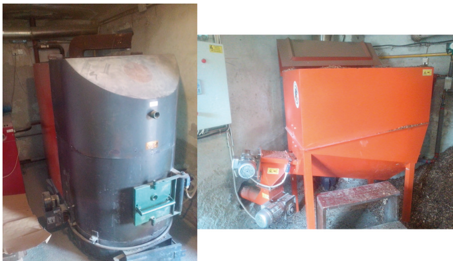
3. kép: Teljesen automatikus 80 KW-os kazán (napközi)
