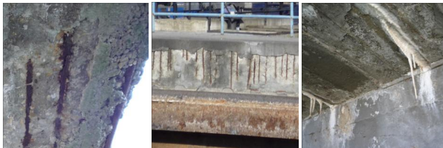
3. ábra. porózus beton, levált betontakarás, mészkő
