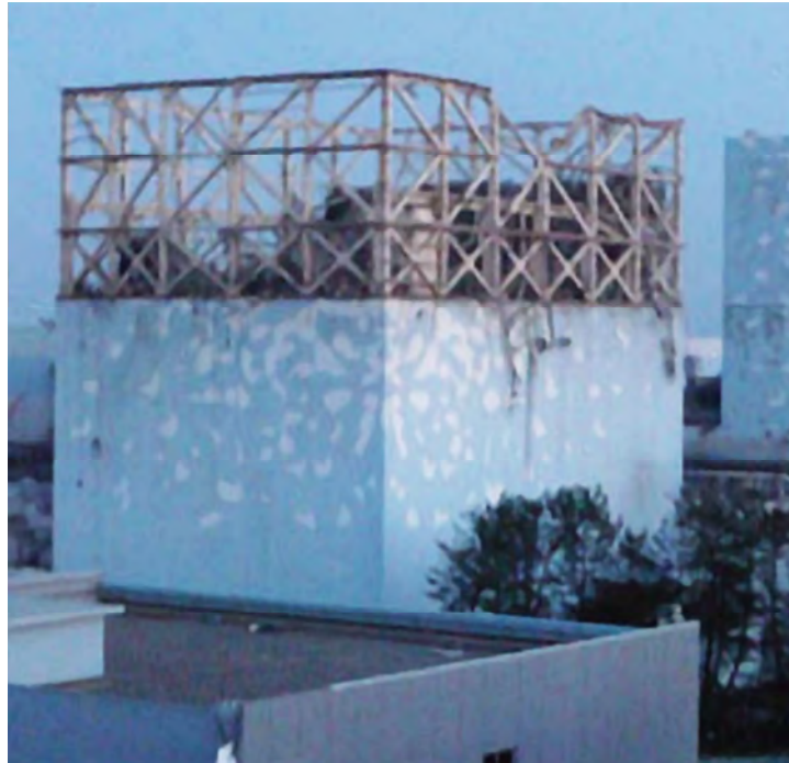
6-1. ábra: Az 1-es blokk épülete a robbanás után [6.3]
